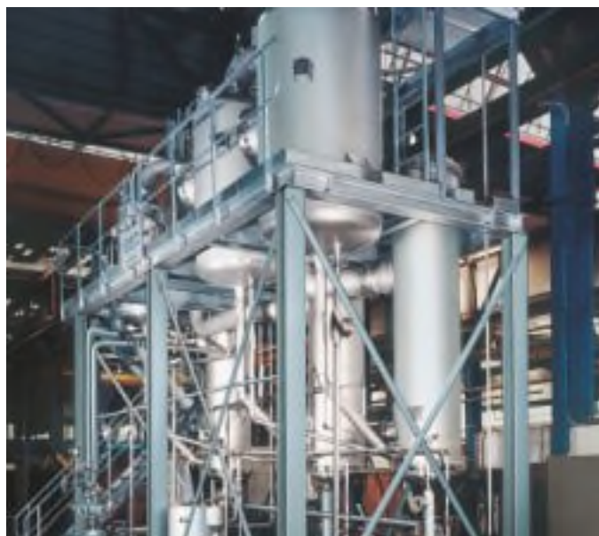
Evaporador de tres efectos de circulación forzada para glicerina. Capacidad de evaporación: 3.600 Kg/h
