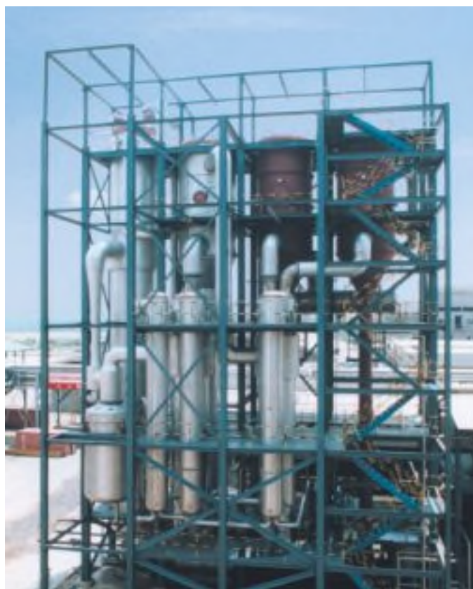
Planta de evaporación de circulación forzada y película descendente de 3 efectos calentada con un termocompresor. Producto: aguas residuales de la producción de glutamato de sodio. Caudal de evaporación: 50 t/h.
