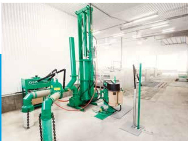
Installation sur le plancher au dessus de la préfosse. La pompe Électromix est munie d'une sortie double pour transférer le fumier dans deux fosses différentes.
