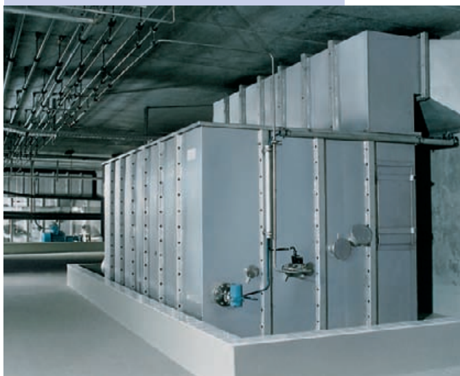
Strahlwaschanlage zur Abscheidung von Farbnebeln aus einer Lackierstraße für Verkehrsflugzeuge, Werkstoff: Edelstahl 1.4571.
