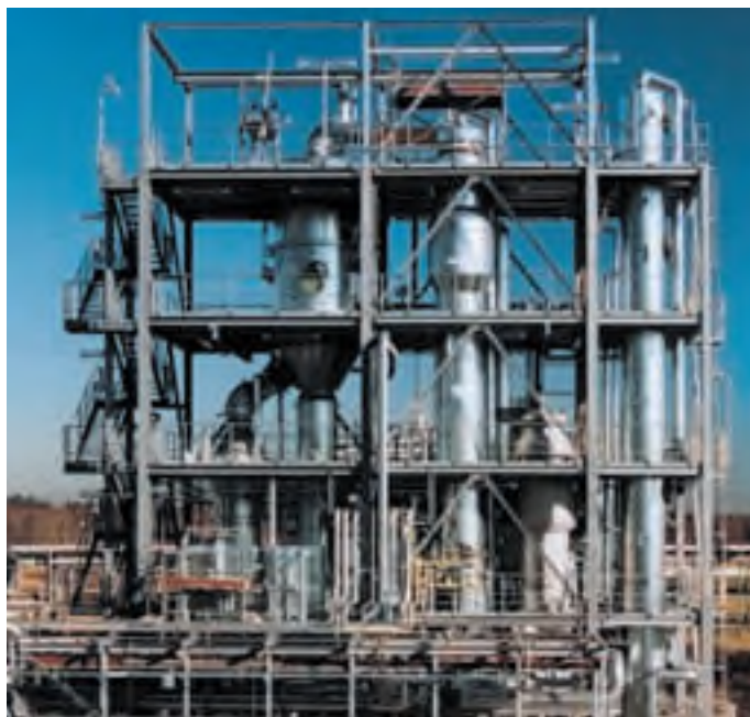
2效降膜强制循环蒸发装置
